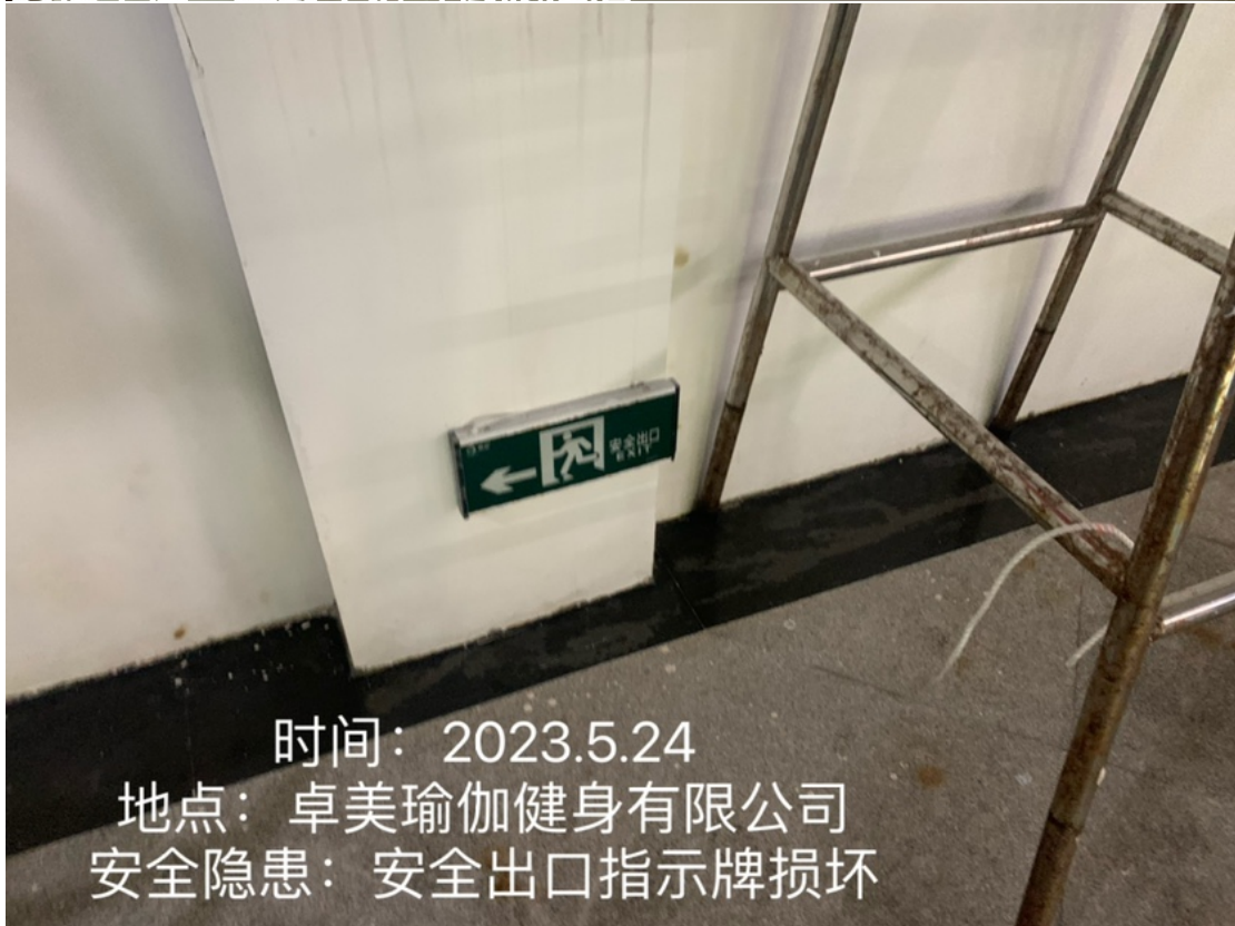
时间：2023年5月24日 地点：登封市崇高路与守敬路交叉口西侧 问题：疏散指示标志损坏 分管领导：郑海波 责任单位：登封市狮峰街派酒店
